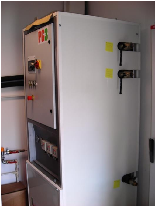
ORC posizionato in centrale termica.
