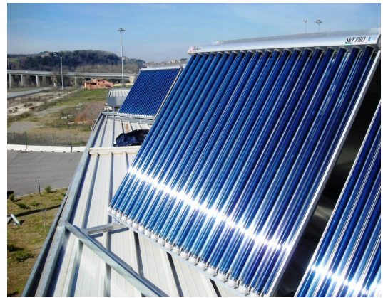
Pannelli solari Kloben Sky Pro installati.
