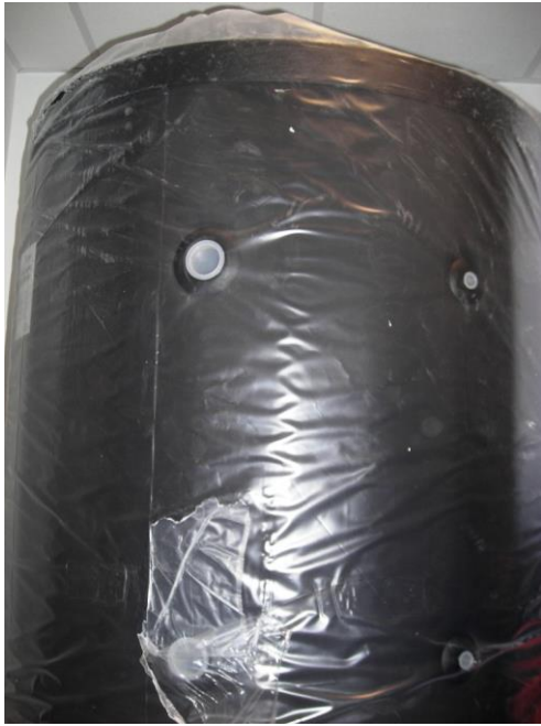
Bollitore all'interno della centrale.
